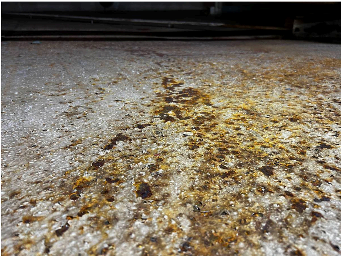
Mynd 4. Málning er illa farin og er yfirbor óslétt.
